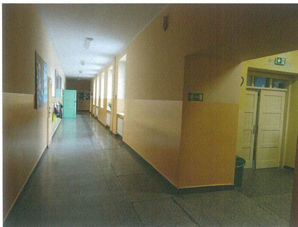
Zdj. nr 4 – korytarz planowanej części przedszkolnej (tu będzie ścianka EI 60 z drzwiami EI60S) , po prawej drzwi wyjściowe z budynku
