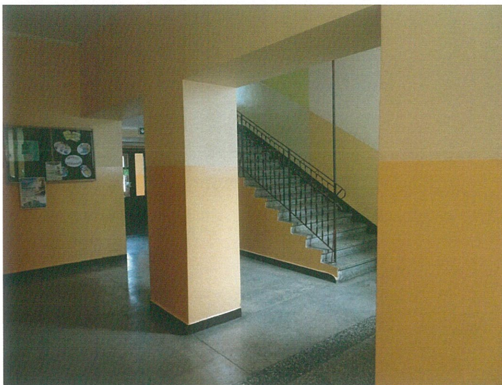
Zdj. nr 5 – słup między korytarzem planowanej części przedszkolnej a przestrzenią klatki schodowej (tu będzie ścianka EI 60 z drzwiami EI60S)
