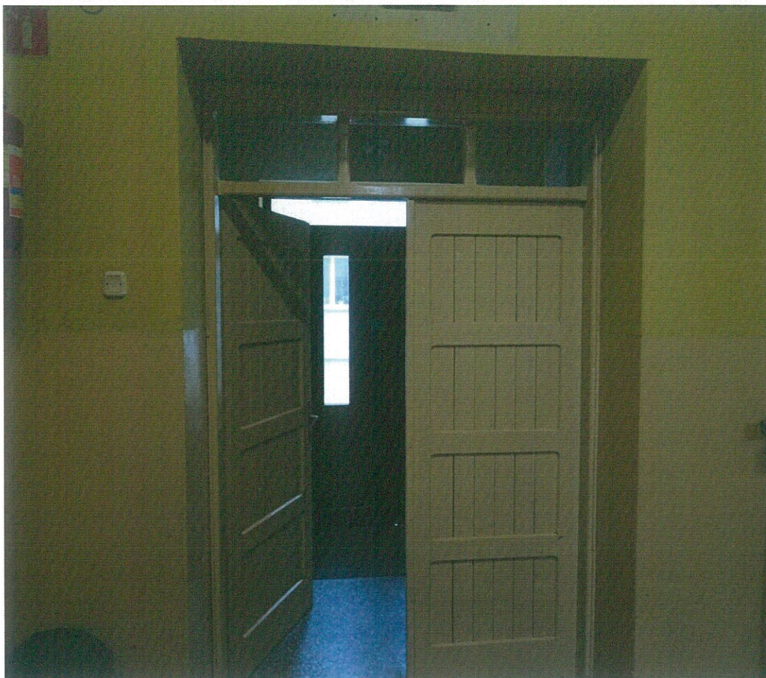
Zdj. nr 7 – drzwi wyjściowe (ewakuacyjne) do wiatrolapu i kolejne na zewnątrz budynku
