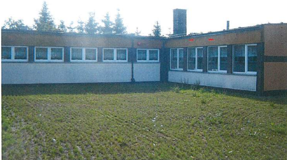
Foto. 6. Ściana nr 4 i 5 z zaznaczonym miejscem gniazdowania wróbla Fot. Przemysław Kubacki
