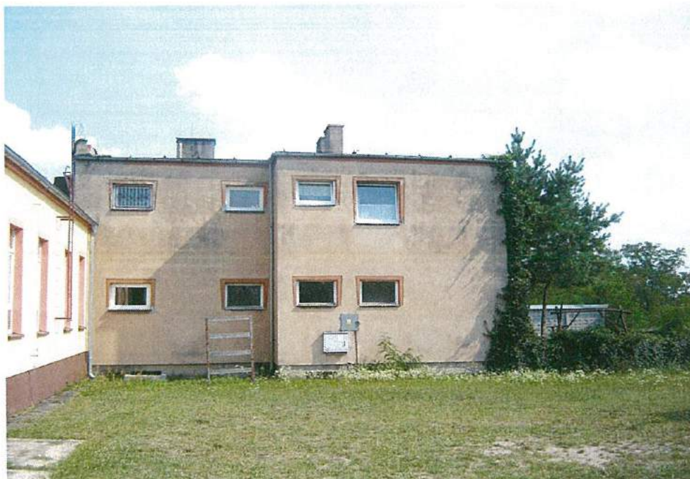
Foto. 4. Północno-zachodnia elewacja budynku z przylegającą z lewej strony Remizą OSP. Po prawej stronie zdjęcia widać porastający budynek bluszcz. Fot. Przemysław Kubacki.
