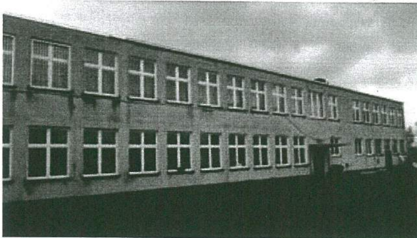
fot. 9 widok elewacji szkoły od strony zachodniej (w związku z wymianą okien wstawione zostały też nowe parapety, pod którymi brak jest szczelin)
