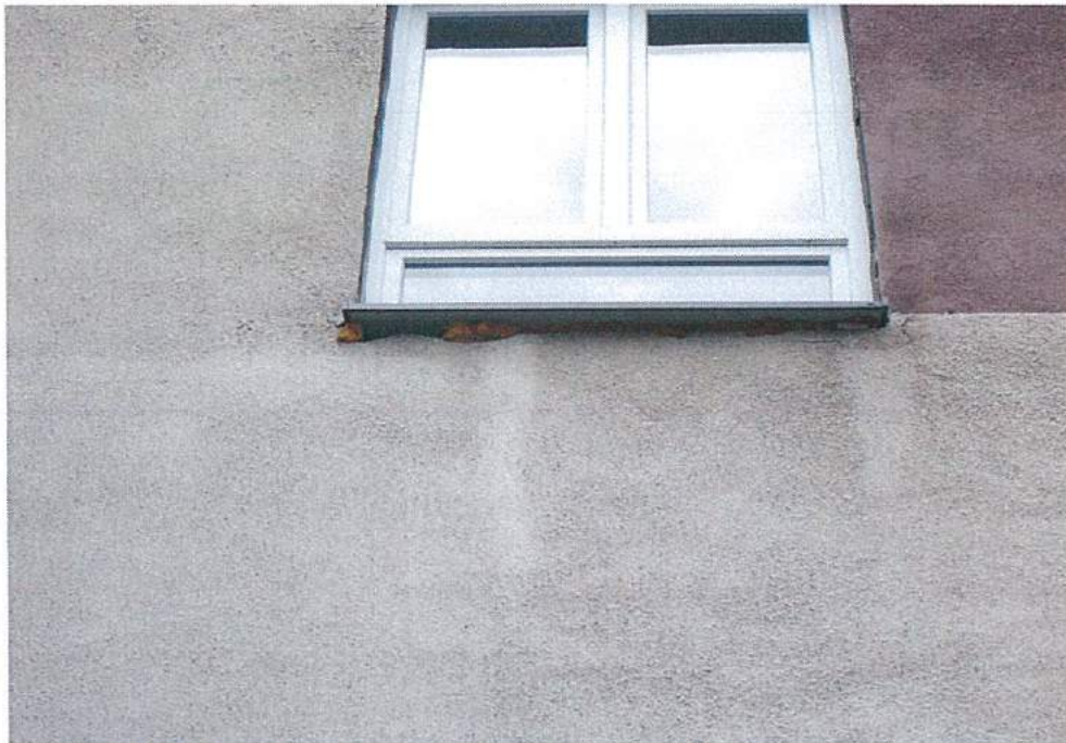
Foto. 17. Miejsce gniazdowania ptaków. Widoczne ubytki pianki pod parapetem Fot. Przemysław Kubacki
