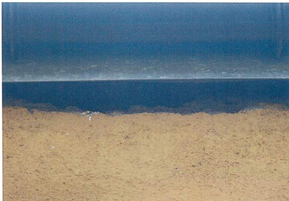
Foto. 15. Przestrzeń pomiędzy obróbką blacharską a murem, miejsce gniazdowania ptaków Fot. Przemysław Kubacki
