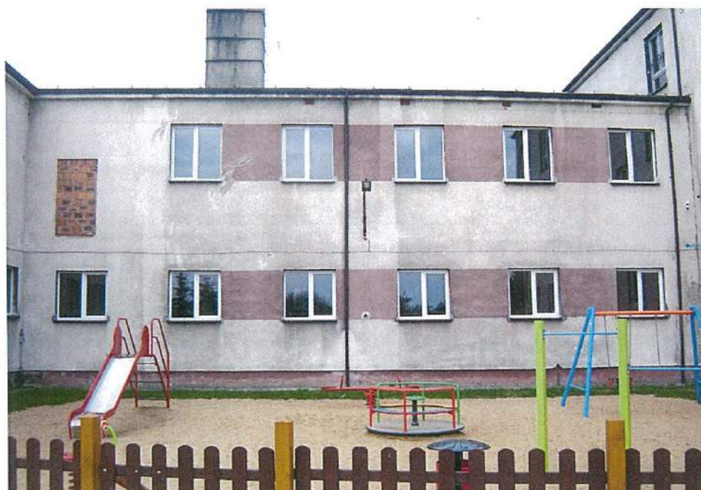
Foto. 11. Ściana nr 8, brak śladów gniazdowania ptaków
