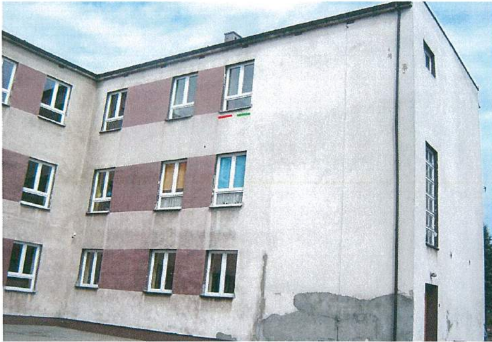
Foto. 6. Ściana nr 3 z zaznaczonym miejscem gniazdowania jерzyka i wróbla. Fot. Przemysław Kubacki
