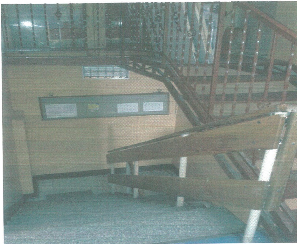
Zdjęcie nr 3 – widok schodów (zejście z pietra) i spocznika po lewej oraz schodów technicznych na nieużytkowe poddasze po prawej
